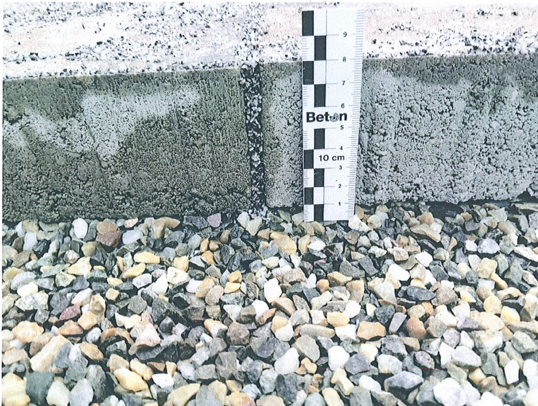
Bild 7: Detailansicht, Fuge nach Bewässerung
