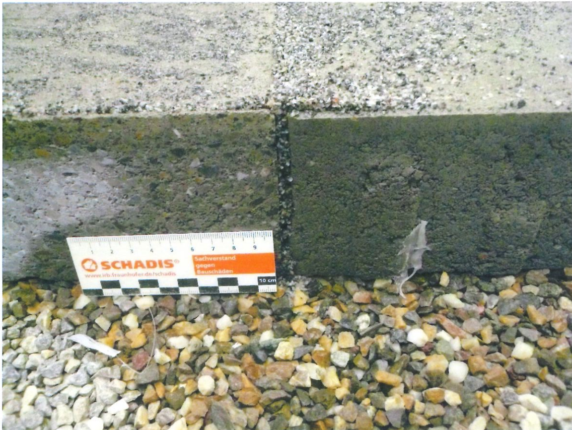
Bild 5: Detailansicht, Fuge nach Bewässerung
